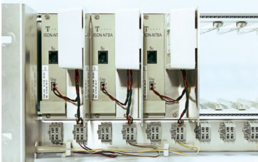
Mischbestückung mit NTBA und Splitter
